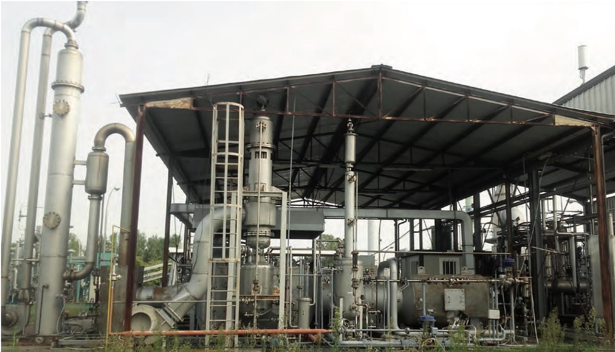
Figura 36: Impianto CFRP per la pirolisi a letto fisso
