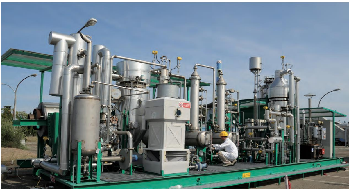
Figura 37: Impianto SICAV per la pirolisi e lo steam reforming per la produzione di carboni attivi syngas da biomasse e rifiuti
