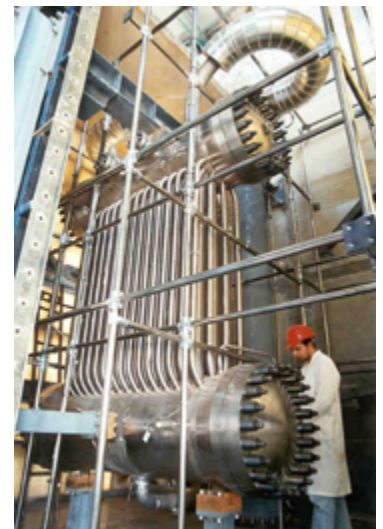
Condensatore di isolamento del SBWR sull'impianto PANTHERS (potenza: 20 MW)
